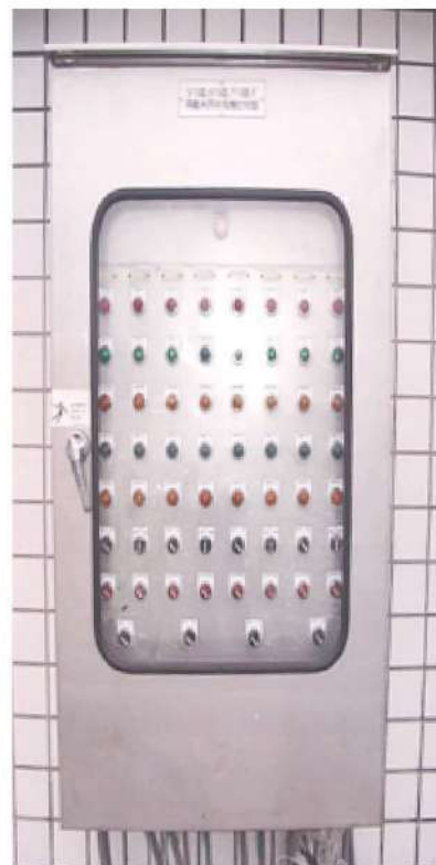
負壓病房空調警報監視盤
