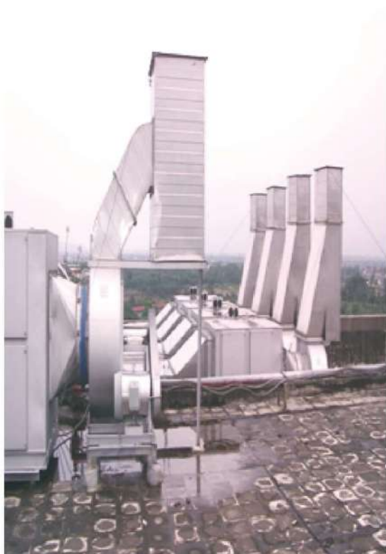
負壓空調主機
