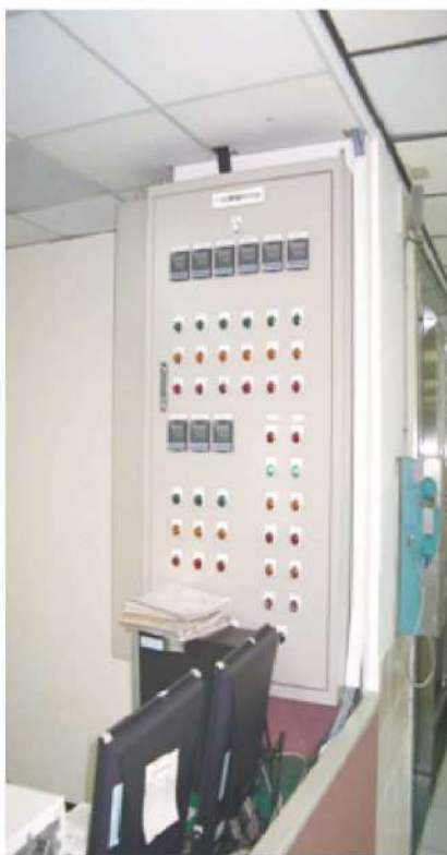
負壓空調主機運轉控制盤
